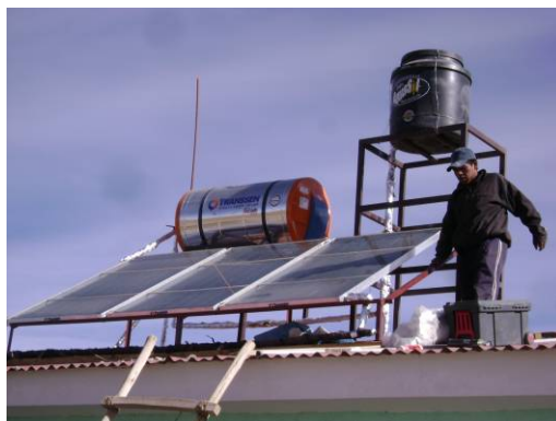
Foto 18. Sistema termosolar concluido.
