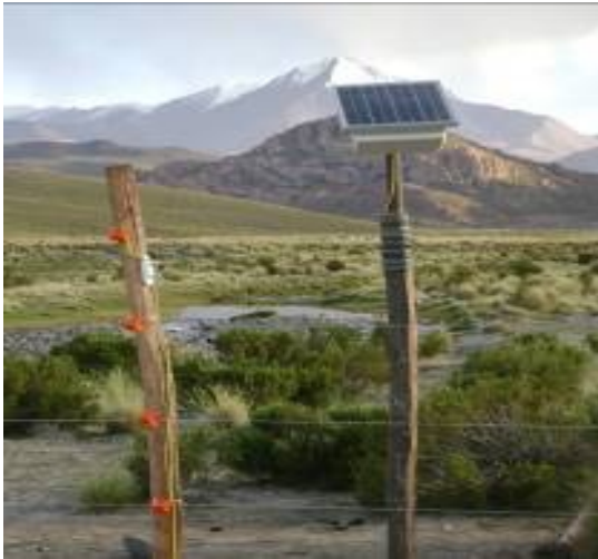
Clausura con cerco eléctrico fotovoltaico
