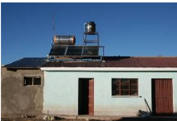
Sistema termosolar en albergue comunitario
