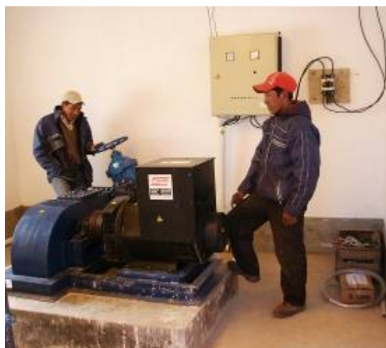
Equipo electromecánico de 30 kW
