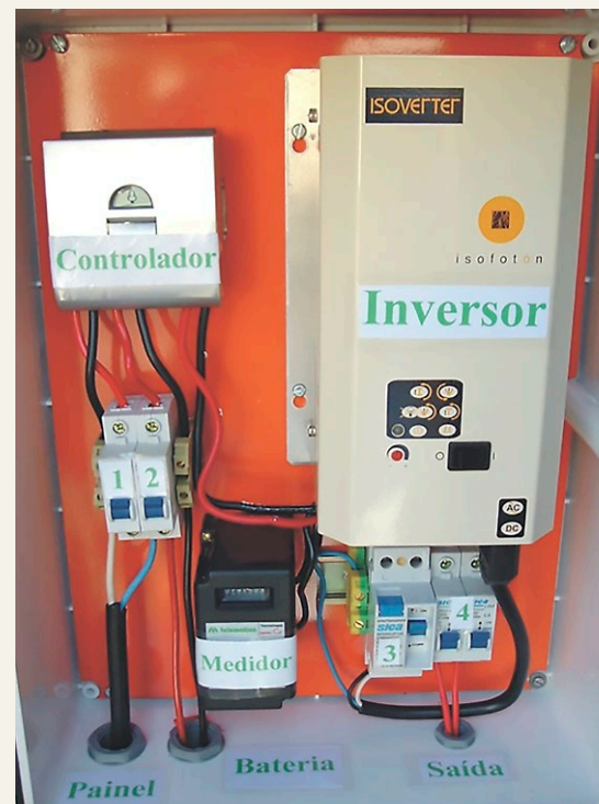
Foto 17 – Detalhe de sistema solar residencial
