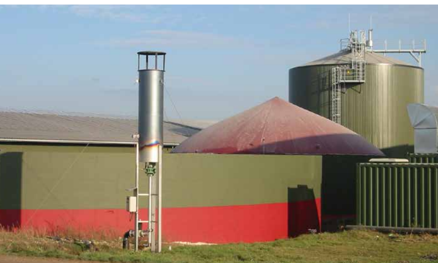
Los quemadores de gas liberan presión excesiva en forma segura.
