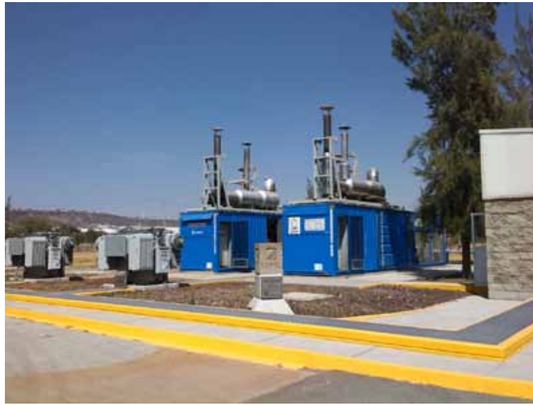
FIGURA 7.6 MÁQUINAS DE COGENERACIÓN POR COMBUSTIÓN INTERNA DE CICLO OTTO INSTALADAS EN LA PTAR DE LEÓN, GUANAJUATO, MÉXICO.
