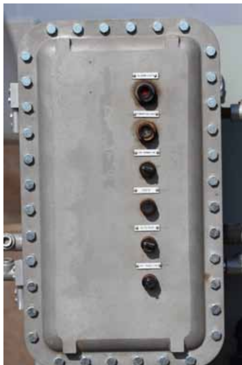
FIGURA 5.7 TABLERO DE IGNICIÓN CONSTRUIDO CON GABINETE A PRUEBA DE EXPLOSIÓN NEMA 7.
