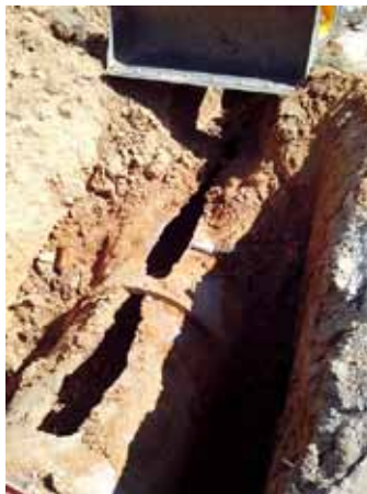
FIGURA 3.21 CANALETA SIN IMPERMEABILIZACIÓN, DESPUÉS DE CORROSIÓN.
