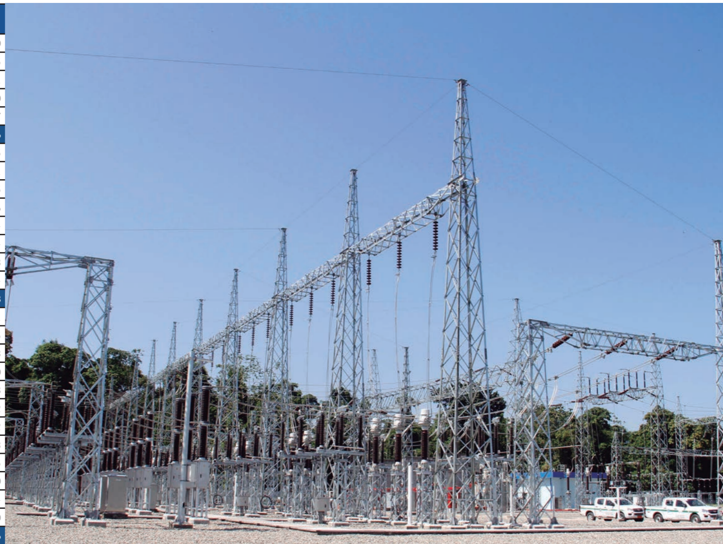
Subestación Eléctrica Shushufindi Foto: Ministerio de Electricidad y Energía Renovable
