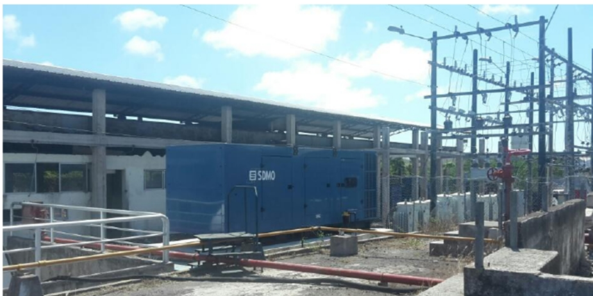
Figura 3: Instalación temporal de un generador de reemplazo junto a la subestación principal de 13.2 kV
