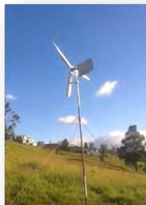
Figura 5.- Aerogenerador Instalado en la Parroquia Tarquí en Ecuador.
